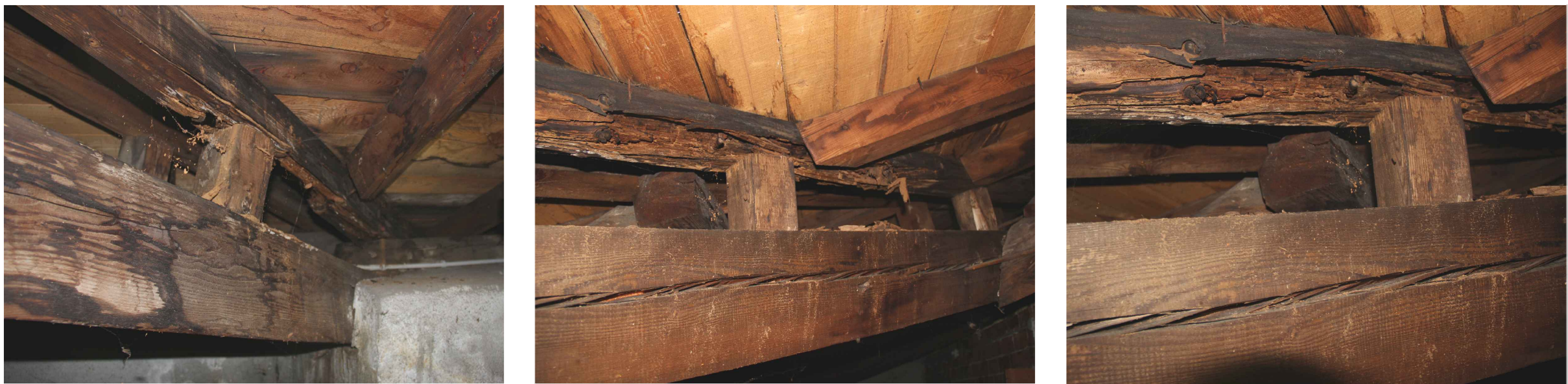
Elementi lignei ammalorati, presenti nei punti di compluvio della copertura - PREVEDERE INTERVENTO DI SOSTITUZIONE
