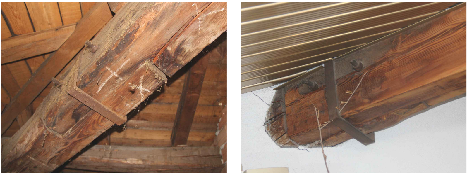
Staffe ed elementi metallici degradati - PREVEDERE INTERVENTO DI PASSIVAZIONE + RIMESSA IN FORZA
