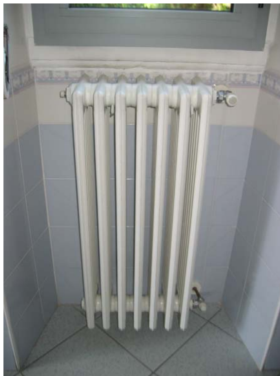
Uno dei radiatori utilizzati per la distribuzione del calore.
