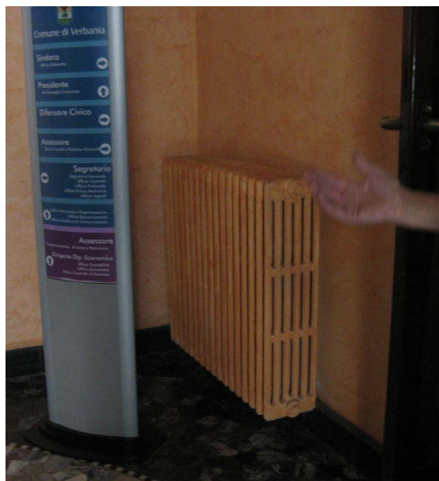
Un radiatore utilizzato per la distribuzione del calore.
