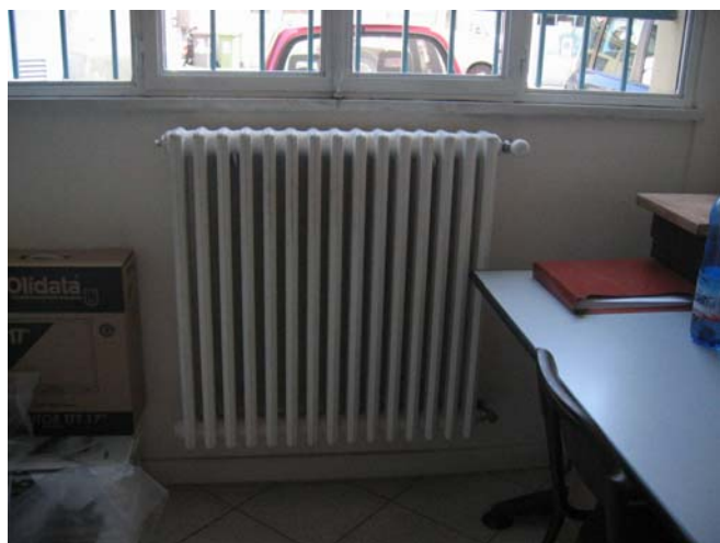
Uno dei radiatori utilizzati per la distribuzione del calore.
